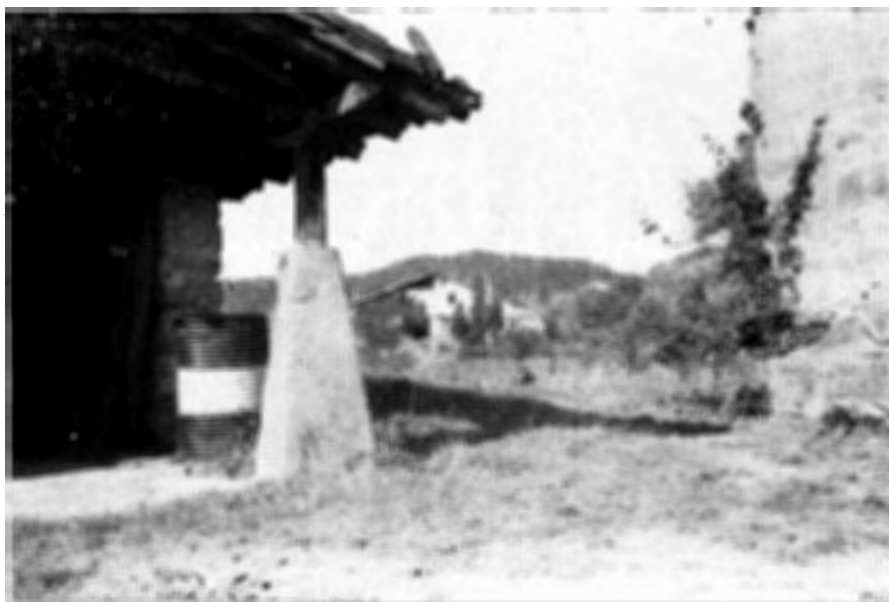
Foto 5: Poste de arenisca, sin duda alguna del hórreo de Azurti, y que se halla el lado del caserío del mismo nombre, sosteniendo una socarrena exterior
